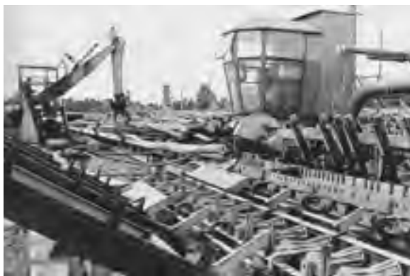
Abb. 541: Langholzmanipulator, Kabine der Einschnittstation, Schlittenkreissäge, 9 m Rollengang mit Anschlagstrecke und Hochförderer (HARTUNG)
