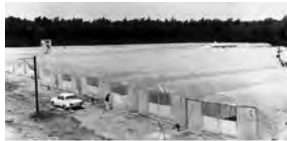
Abb. 127: Folienzeltanlage der ZWZ in Waldsiefersdorf (Archiv WSD)
