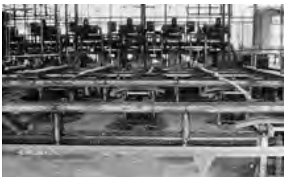
Abb. 546: Querkettenförderer mit Hubböcken und 6-Messereinschnittanlage (Archiv FIEDLER)
